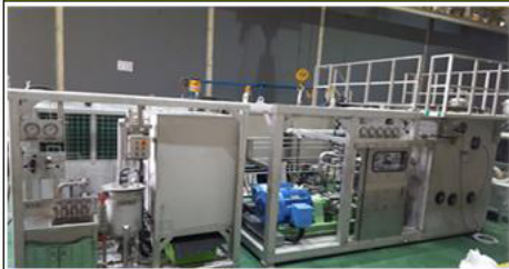
원자로냉각재펌프 내장품 화학제염설비
