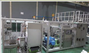
원자로냉각재펌프 내장품 화학제염설비
