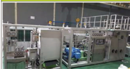
원자로냉각재펌프 내장품 화학제염설비
