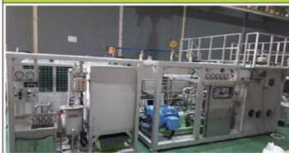
원자로냉각재펌프 내장품 화학제염설비
