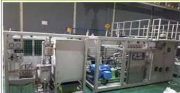
원자로냉각재펌프 내장품 화학제염설비
