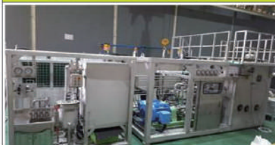
원자로냉각재펌프 내장품 화학제염설비
